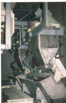
1-Station de mélange eau-plâtre.
